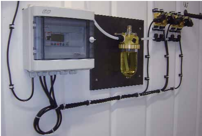
Abb. 2: Zentrale Steuereinheit, Spray-Dosierer, Magnetventile, zur gezielten Druckluftschlauch Steuerung.
